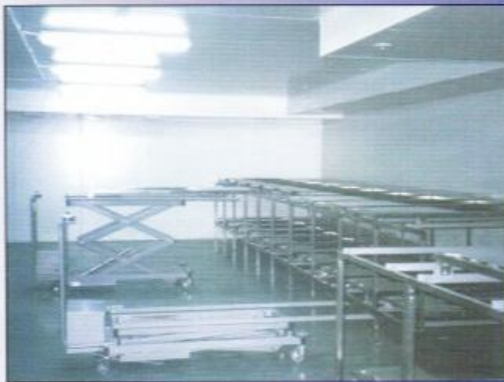
Miejska chłodnia na Cmentarzu Komunalnym Południowym w Warszawie: stelaże do przechowywania trumien i wózki - podnośniki
